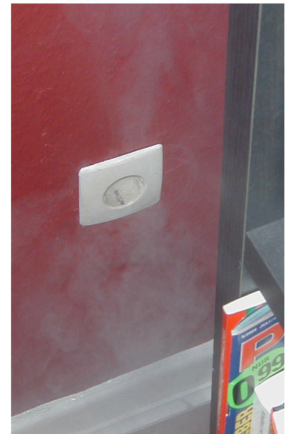
Abb. 2: Kaltlufteintritt aus der Luftschicht zweischaligen Mauerwerks - markiert durch Diskonebel.
