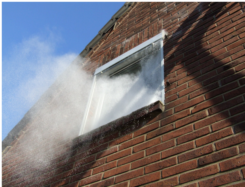
Abb. 1: Diskonebel tritt von der Luftschicht über Fensteranschlusffugen nach außen aus. Über die Fugen dringt kalte Außenluft nach innen ein.
